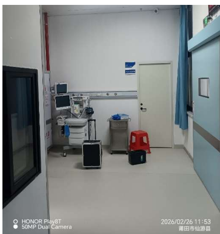
DSA1 室南侧缓冲区、设备间
